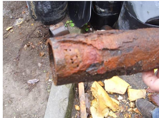
Corrosion sur piquage
