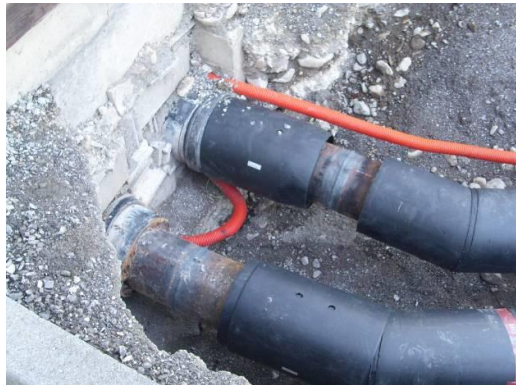
Fuite sortie chaufferie
