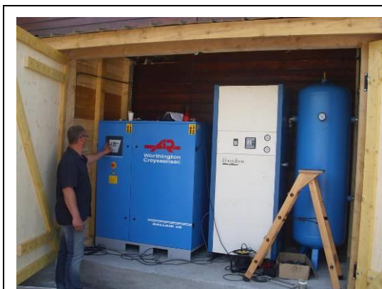
Compresseur pour le nettoyage des FAM
