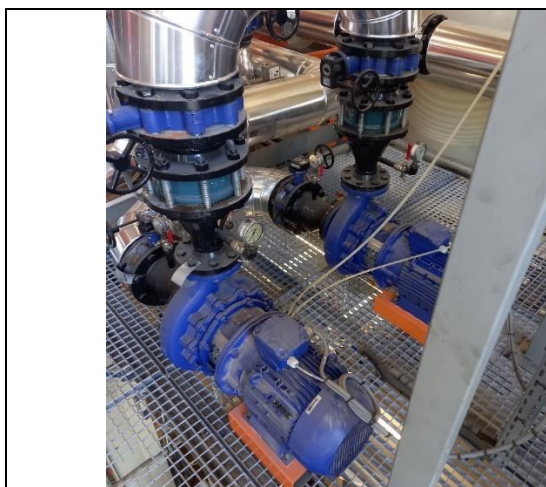
Pompes de charge chaudière bois
