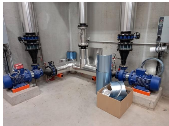
Pompes de charge chaudière gaz
