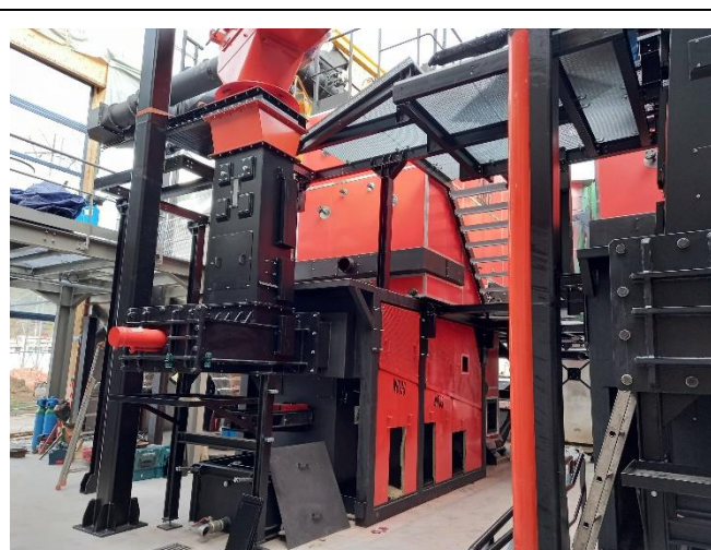
Chaudière n°1 1650 kW
